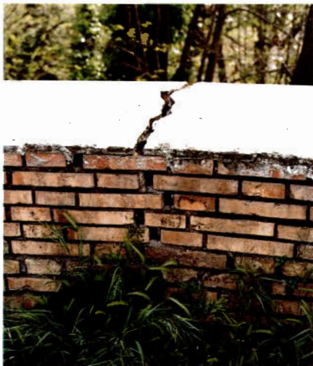
Fig. 3 – Particolare delle fessure e crepe nel muretto di Via A. Saffi, all'altezza dell'incrocio con Via delle mura gianicolensi. (foto: M. Amanti).
