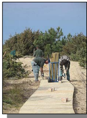
Realizzazione di un sentiero per evitare il calpestio sulle dune (Foto dal sito www.parcosanrossore.org )
