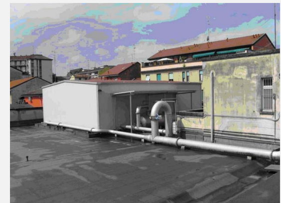
Impianto filtri a carbone attivo (sopra) e impianto osmosi inversa (sotto)
