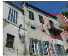
elemento aggettante in precarie condizioni
