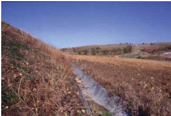
Foto 25 – Canaletta in metallo con problemi di sifonamento (Foto G. Sauli)
