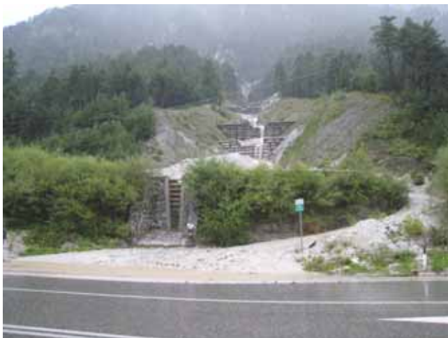
Foto 106 – Interventi stabilizzanti e di consolidamento di IN abbinati a briglia filtrante – Rio Anonimo (SS 13 Pontebbana – Loc. Ugovizza (UD) – Foto G. Sauli)
