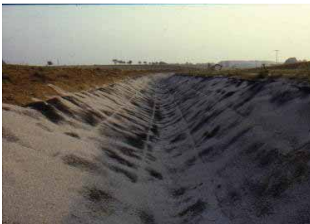
Foto 31- Canale autostradale in geostuoia tridimensionale sintetica seminata, intasata di ghiaino e bitumata in loco. Oltre che funzioni di scorrimento tali strutture verdi assolvono anche funzioni di infiltrazione con effetti benefici di filtrazione del particolato e ripascimento delle falde. (Germania – Foto G. Sauli)
