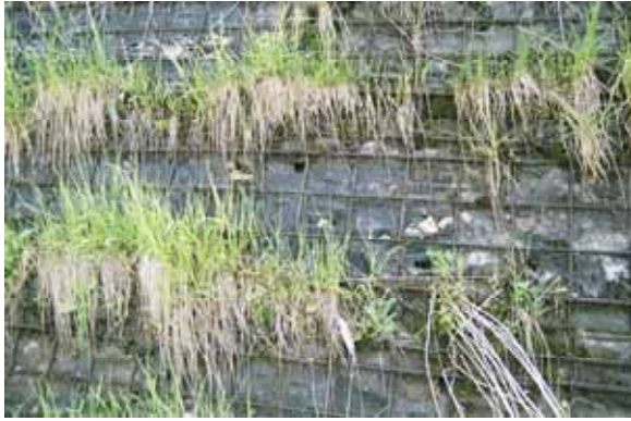
Foto 50 - Evidente assenza di terra vegetale e stuoie inadeguate limitano la crescita delle erbe alle strisce di contatto tra gli strati delle armature orizzontali (foto G. Sauli)
