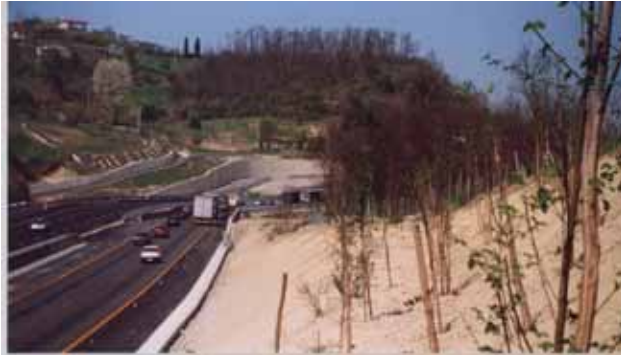
Foto 24 - Autostrada Fiano –Orte – Scarpate in trincea in argilla minerale – Piantagione di arbusti ed alberi (Foto G. Sauli 1998)
