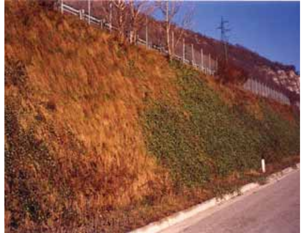
Foto 127 – L'uso di edera rampicante su cotici erbosi paraturali su terre rinforzate verdi soffoca le specie del prato – pascolo ed azzerà la biodiversità (Autostrada V. Veneto – Pian di Vedoia loc. Fadalto – Foto G. Sauli)
