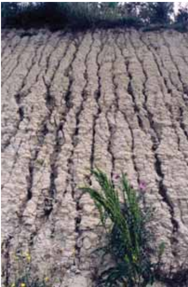
Foto 2 - Inizio di solchi di erosione su scarpate non rivegetate in trincea in litologia sciolta a matrice argillosa. (3° corsia autostrada Orte-Fiano Foto G. Sauli)
