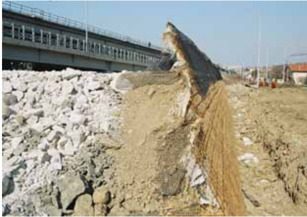
Foto 55 - TRV con armatura orizzontale in reti sintetiche e casseri esterni in griglie metalliche, reti sintetiche e stuoie organiche. Si noti la terra vegetale addossata alle stuoie e reti esterne (GVT loc. Domio – Foto G. Sauli 2008)
