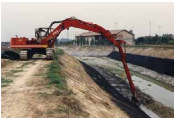
Foto 107 – Interventi spondali con geostuoie sintetiche tridimensionali bitumate in loco (Fiume Dese presso ponte autostrada A4 –VE) Foto G. Sauli
