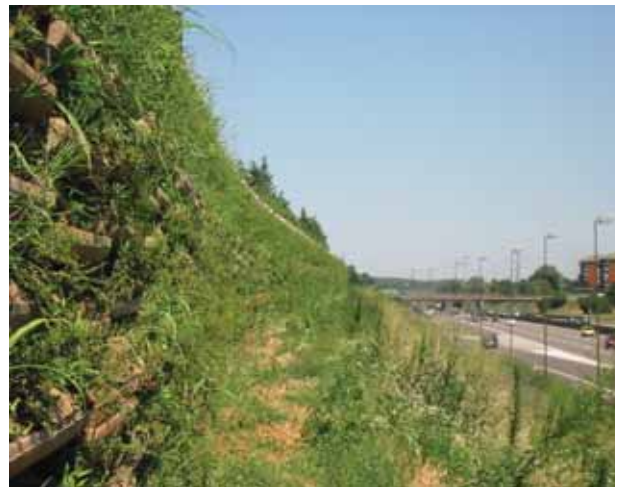
Foto 76 – Barriera antirumore in cls vegetata (Tangenziale di Torino - Foto R. Santero)
