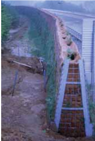
Foto 79 – Barriera antirumore vegetata ad arbusti autoctoni in terrapieno compresso in struttura metallica (Autostrada dei Trafori – Foto G. Sauli fine anni '80)
