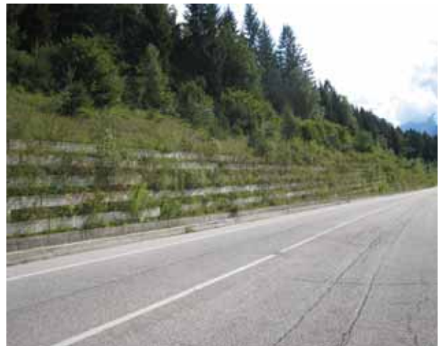
Foto 64 - Muro cellulare in cls con arbusti autoctoni (Strada per la nuova Stazione di Tarvisio Bosco Verde – foto G. Sauli 2009)
