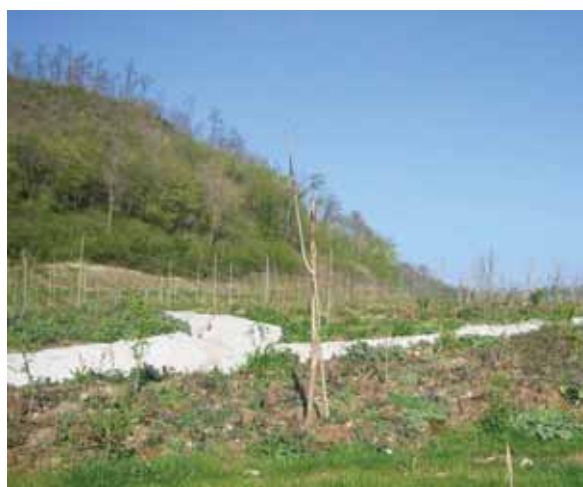
Foto 34 - Rivegetazione area boscata rilevato galleria Pileggi (3ª corsia Autostrada Orte-Fiano fine anni '90). Visibile un fosso di guardia realizzato in cls. (Foto P. Cornolini)
