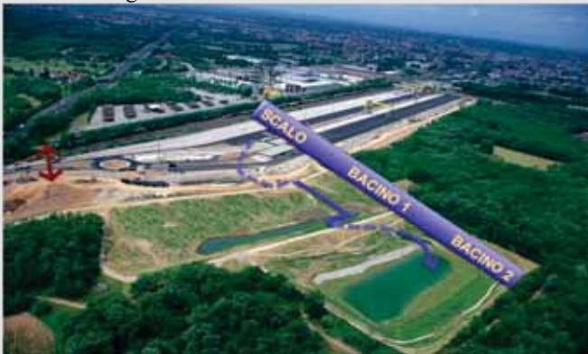
Immagine del biotopo in fase di cantiere. La linea azzurra indica il percorso dell'acqua. La freccia rossa il posizionamento dei sottopassi faunistici.
