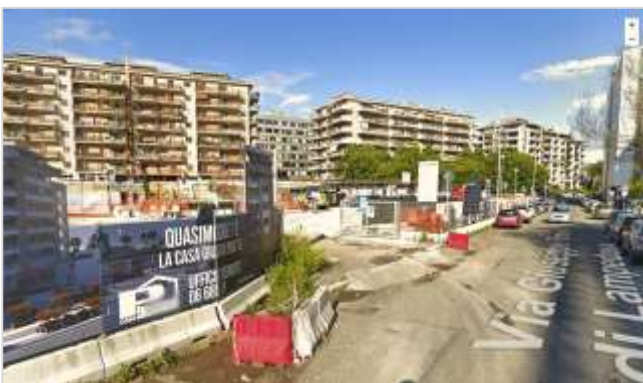
Fig. 29 Foto del cantiere lungo via G. Tomasi da Lampedusa e via S. Quasimodo
