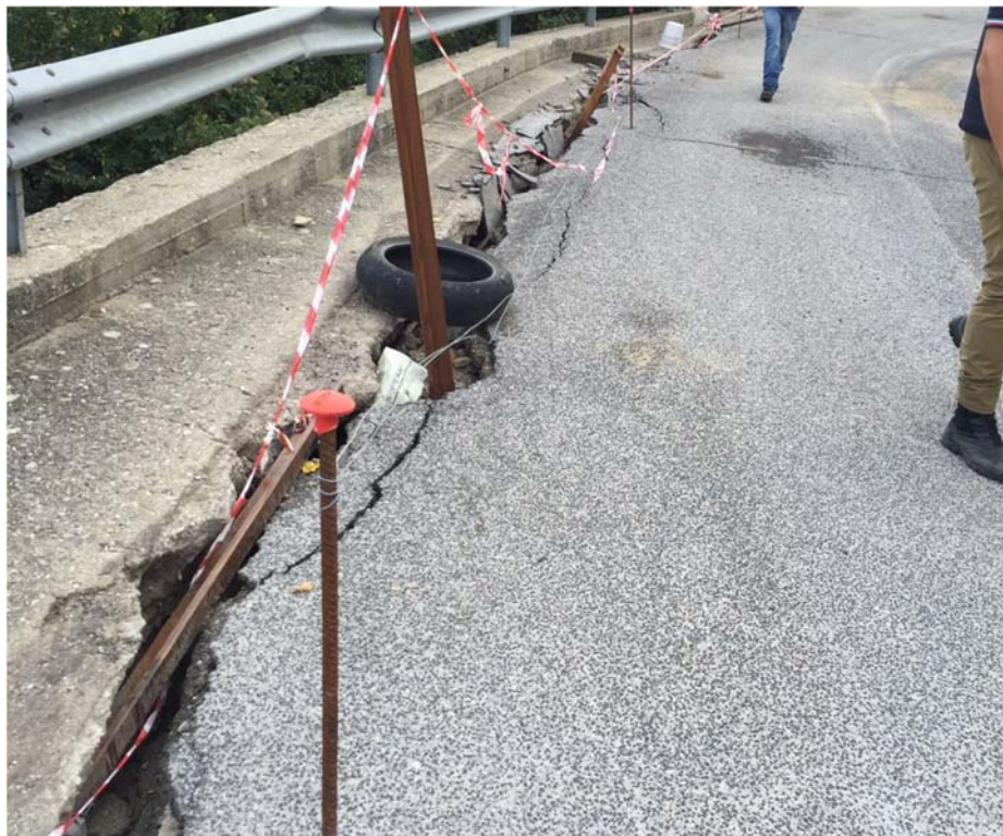
Dissesto Accumoli (RI): frattura longitudinale esterna ubicata al ciglio della strada. Vista verso SE.
