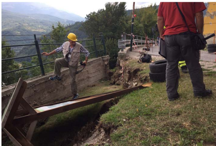
Dissesto Accumoli (RI): piccolo parco pubblico con ribassamento e rotazione del muro di sostegno esterno e conseguente gradonatura del terreno di riporto a tergo del muro. Vista verso SE.
