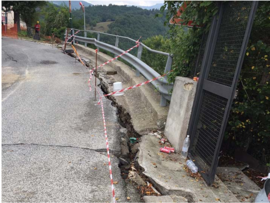
Dissesto Accumoli (RI): frattura longitudinale esterna ubicata al ciglio della strada. Vista verso NW.
