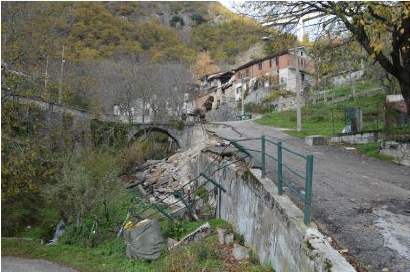
FIG 3. Zona in cui va realizzato il bypass onde evitare di occupare la sede stradale soggetta a crollo
