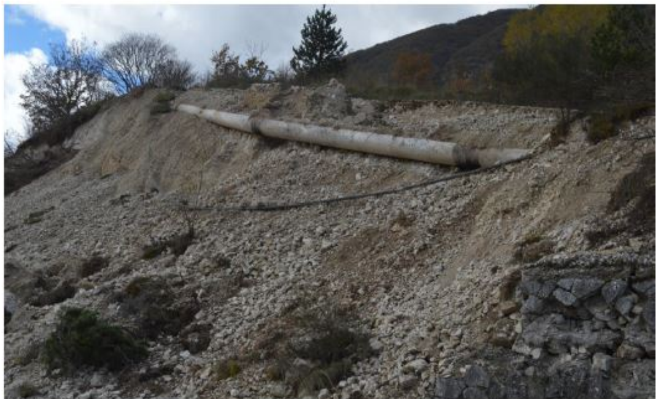
FIG 2. Tratto acquedotto affiorante lungo lo sperone instabile di detrito
