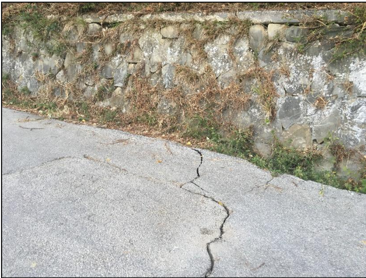
IS1_4. Fratture in prossimità del bivio subito fuori dell'abitato di Cossito.
