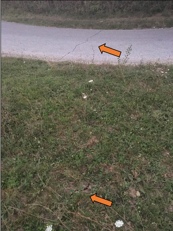
IS1_5. Frattura sul tornante lungo la strada che collega Cossito a Saletta, poco a valle di Casale.
