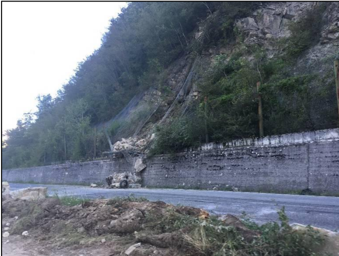
IS1_1. Crollo di blocchi arenacei lungo la strada che collega la SS Salaria ad Amatrice.
