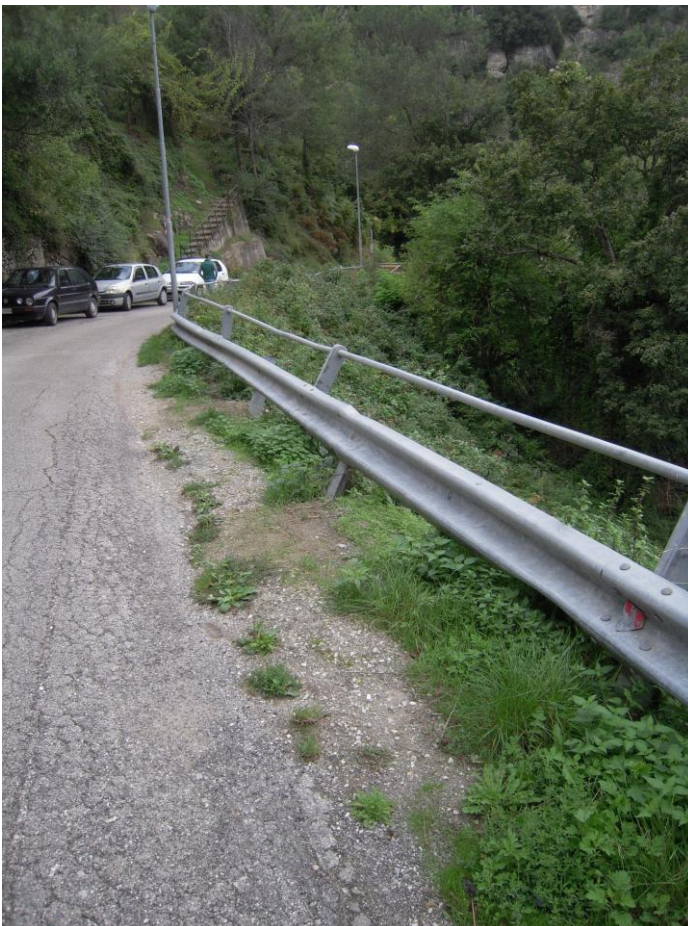
Fig. 4 – Fratture lungo la sede stradale, nel settore di corona della frana
