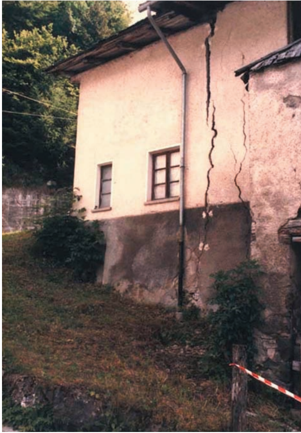
Fig. 4 - Particolare delle lesioni di un edificio della frazione di Andrich, comune di Vallada Agordina (BL)
