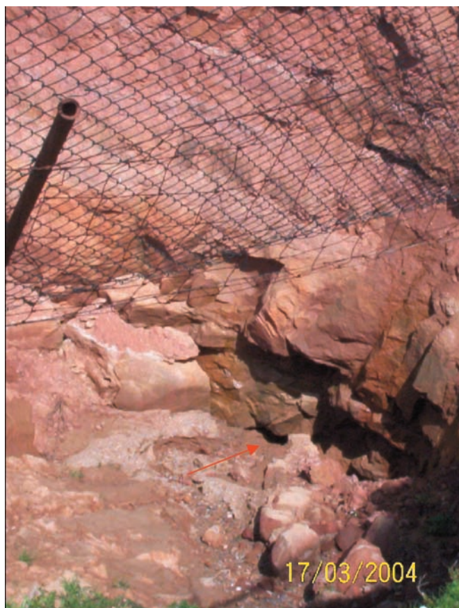
Foto 3 - Sinkhole Monte Ollastu. Particolare della foto 2. La freccia evidenzia la cavità di fondo del sinkhole.
