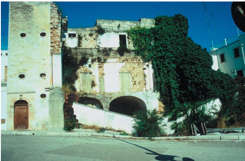
Fig. 3 - Danni ad edifici siti a Largo Porta Grande, nella zona topograficamente più bassa di Castellana-Grotte (foto del 1999). L'area è stata successivamente bonificata.
