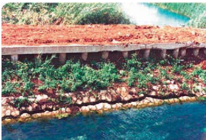
Foto 15: Agosto 1991, rottura dell'argine del Fiume Ufente (in alto). Particolare della frattura (in basso).
