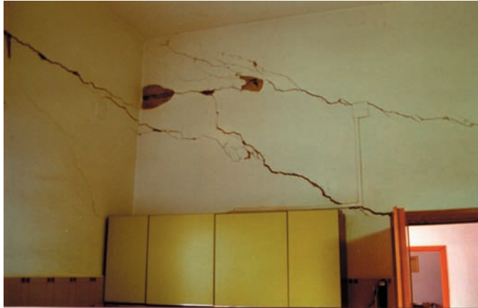
Foto 2 - Effetti della subsidenza indotta, lesioni su di una abitazione in loc. Bandita
