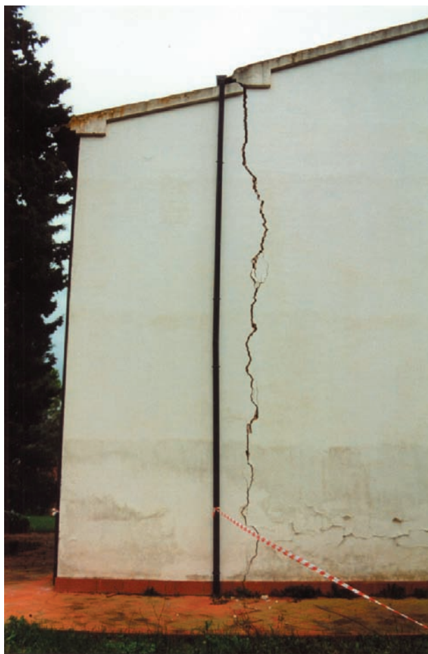
Foto 1 - Effetti della subsidenza indotta, lesioni su una abitazione in loc. Affitti
