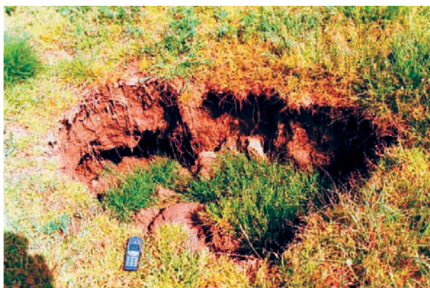
Foto 5 - Sinkhole – probabile coalescenza di più camini di collasso
