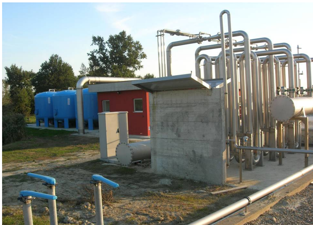
Figura 9: impianto in scala reale (reattori ozono e filtri a sabbia)
