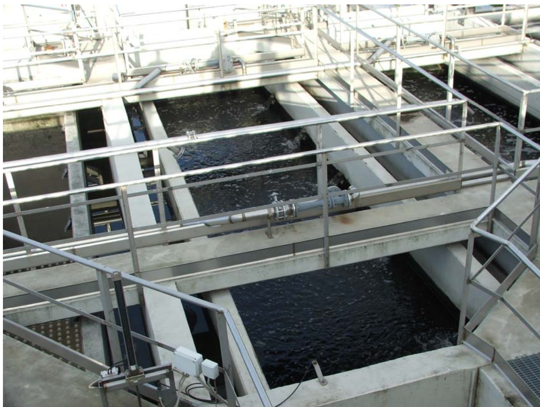
Figura 5: impianto di riciclo CONSER: vasche di filtrazione con carboni attivi
