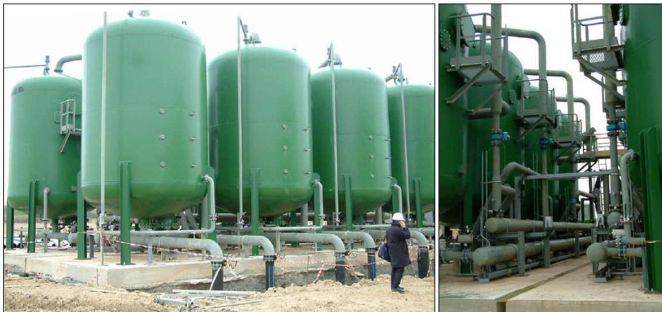
Figura 18: Batterie di filtri ad adsorbimento a carboni attivi
