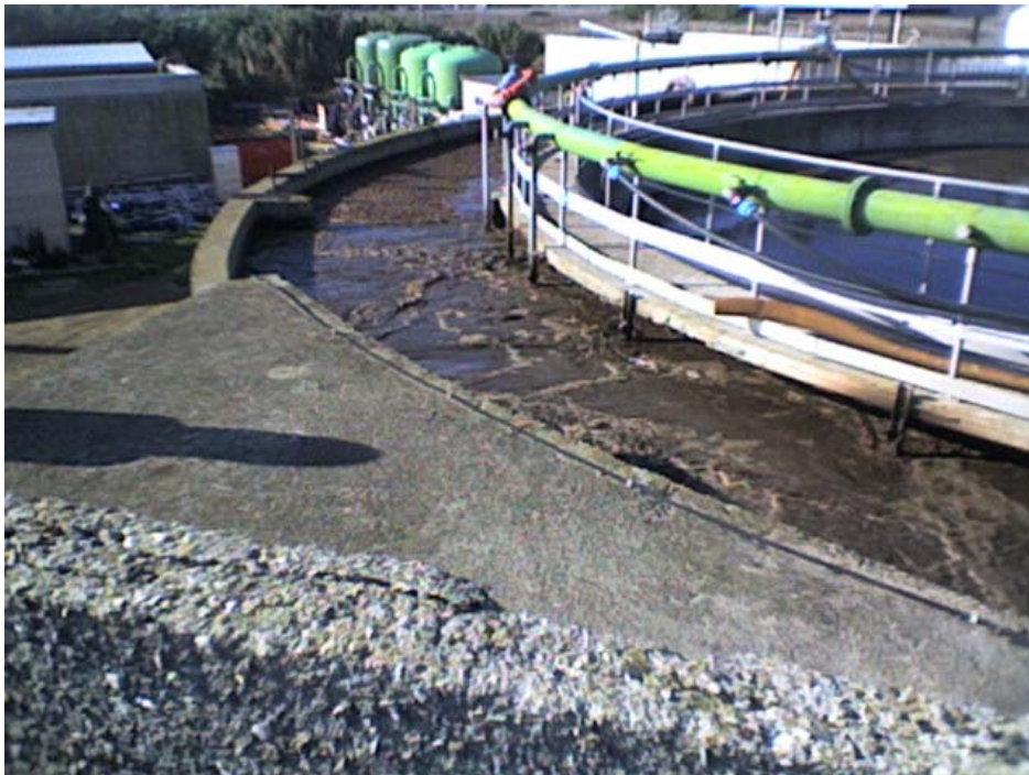
Figura 22: particolare dell'impianto di depurazione di Bibbona
