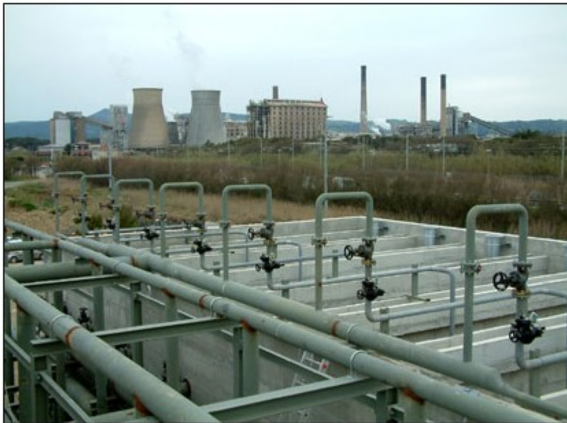
Figura 17: Unità di biofiltrazione aerata
