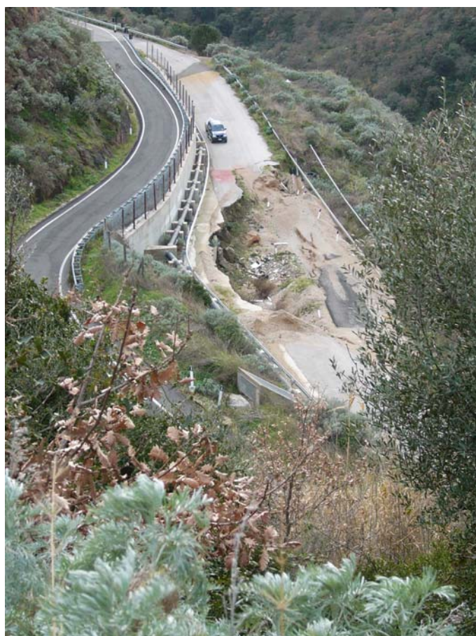
Figura 25.11 Strada provinciale n°41 bis Ittiri-Banari; frana di Scivolamento rotazionale unita a crollo su ignimbriti lapidee, a carico di un substrato alterato di piroclastiti, Comune di Ittiri (SS).
