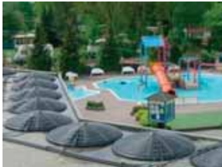
c) L'impianto solare per il riscaldamento di una piscina – ESTIF
