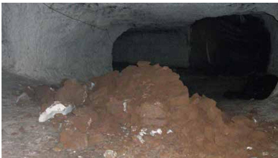
Fig. 2 – Reticolo caveale presso Via di Tor del Fiscale; è possibile vedere i continui crolli a cui sono sottoposte le gallerie.
