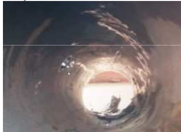
Figura 2 Foro cagionato da colata laterale di ghisa liquida a carico della tubiera n. 9 dell'AFO4
