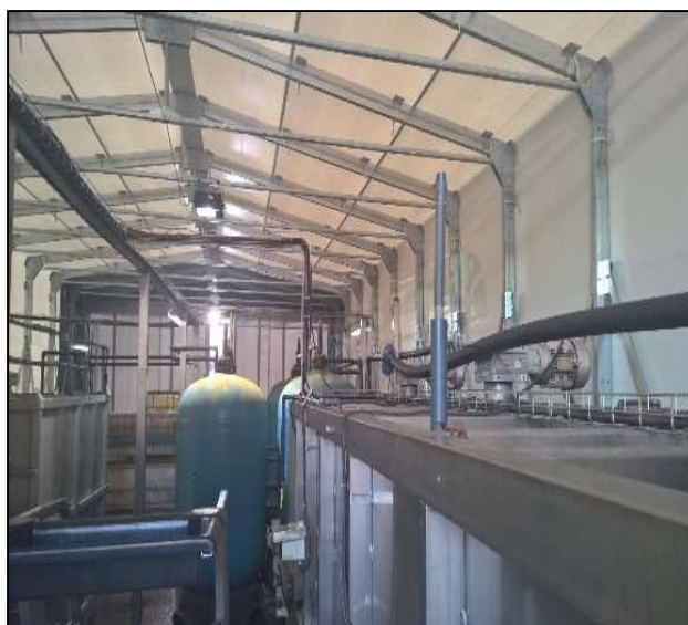
Impianto Pump & Treat
