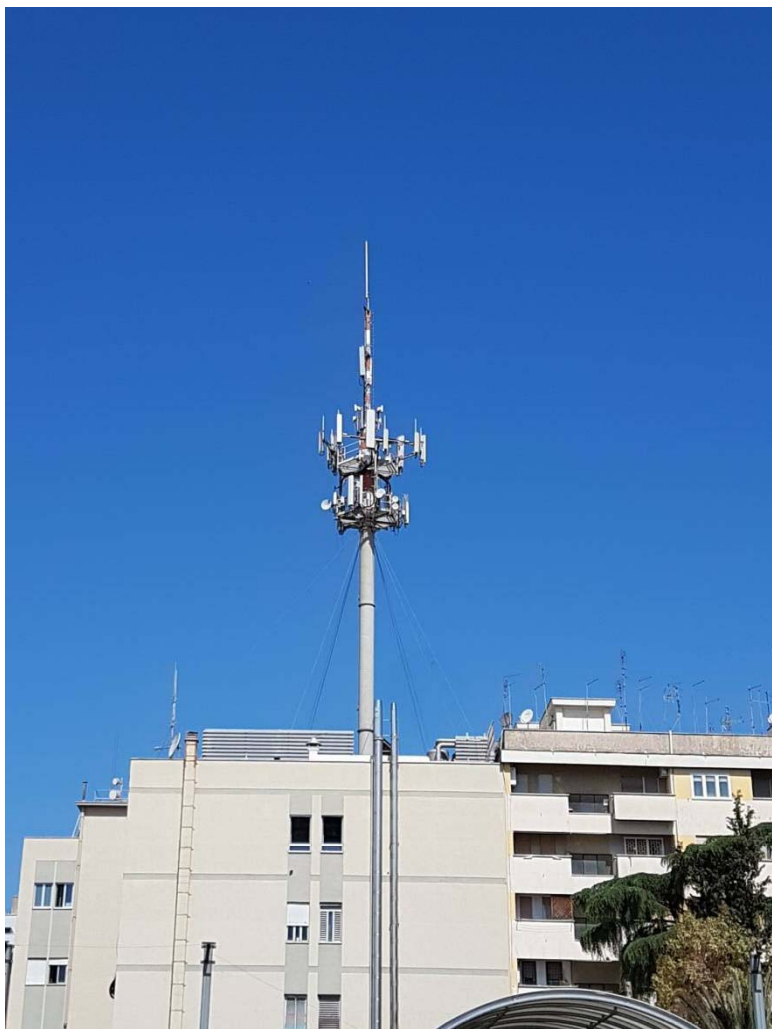
Foto: impianto SRB oggetto di indagine
