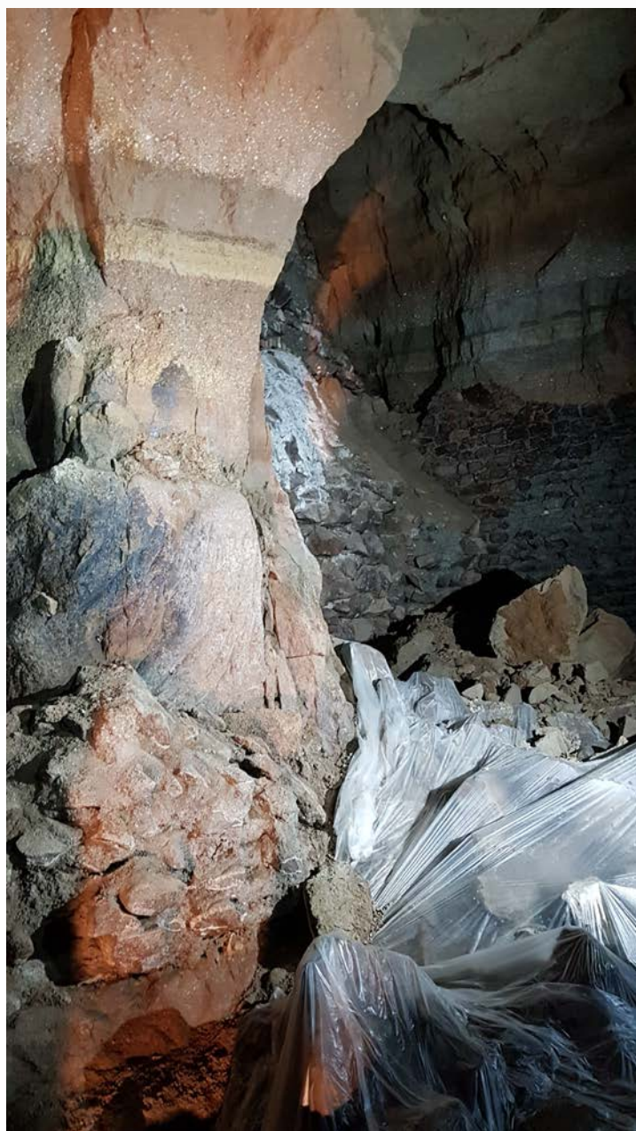
Figura 10 – Blocchi crollati a terra
