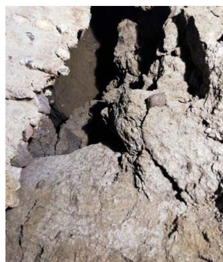
Figura 5 - Cavità posta a tergo del rivestimento in cemento armato
