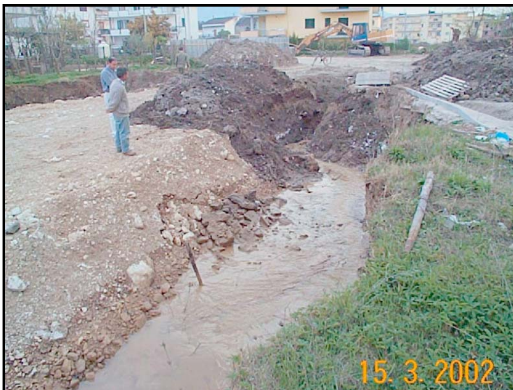
Fig. 20 – Foto mostrante la fase di riempimento del sinkhole con materiale grossolano, fornita dal Dott. Geol. G. Moriello.
