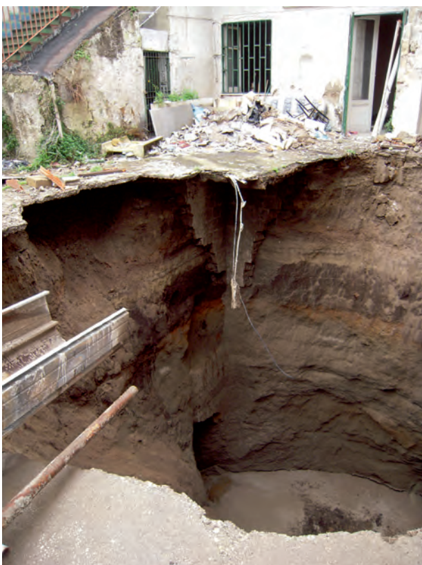
Fig. 14 – Rinvenimento alla base dello sprofondamento del 9/1/2014 di una cavità non conosciuta. - The discovery of a not known cavity underlying the January 9 th 2014 sinkhole.
