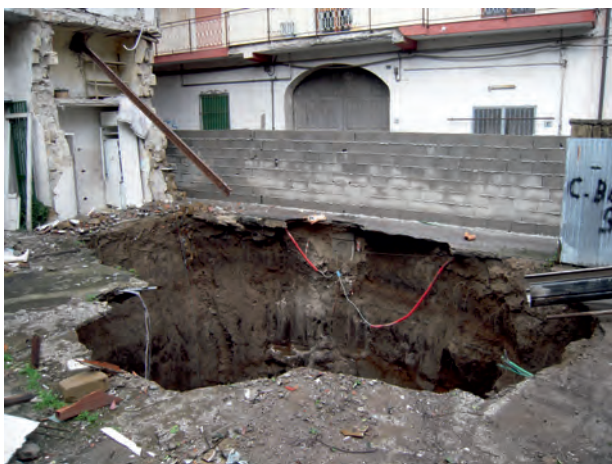
Fig. 13 – Il sinkhole del 9 gennaio 2014 a Grumo Nevano (NA). - the January 9 th 2013 sinkhole at Grumo Nevano (NA).
