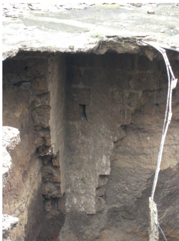
Fig. 15 – Canna di pozzo nascosta dalla pavimentazione, probabile innesco dello sprofondamento. - Access well hidden by pavement, likely trigger of the collapse.
