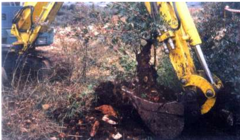
Foto 100 – Metanodotto Metanodotto Bernalda – Brindisi, Loc. Massafra, durante lavori di trapianto di arbusti di arbusti di gariga mediterranea – Foto G. Sauli, dicembre 2001
