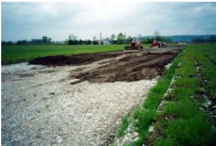
Foto 51 - Metanodotto Bordano – Flaibano Loc. Piani di Osoppo; trapianti in zolla con zolle poste a strato singolo su pallet con foglio di polietilene; spessore medio zolle 10 cm, preparazione fondo con stesura terreno rimosso in precedenza – Foto G. Sauli, 2004
