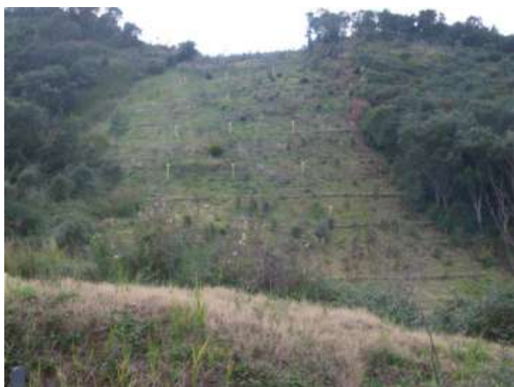
Foto 111 – Metanodotto zona autostrada SA-RC. Stabilizzazione di versanti mediante opere morte (canalette con palizzate) e vive, semine, messa a dimora di arbusti autoctoni. L'abbinamento opere morte opere vive è dovuto al superamento dei limiti di applicazione delle tecniche stabilizzanti con materiale vivo in zone a forte aridità - Foto G. Sauli
