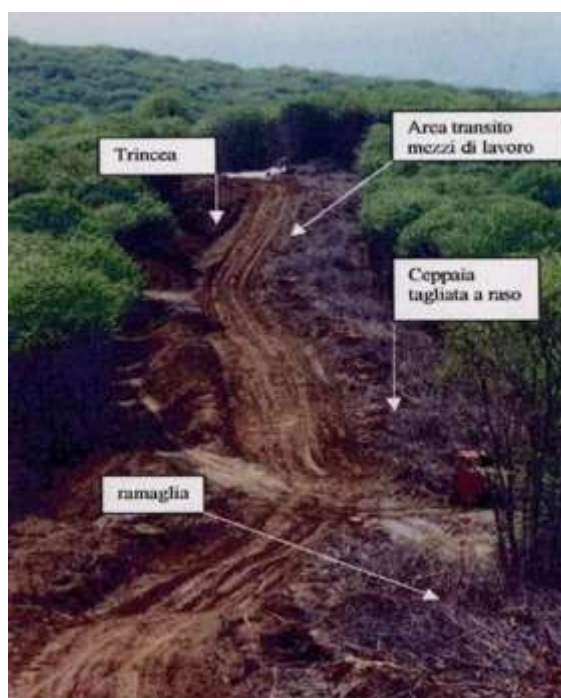
Foto 29 - Metanodotto P.so Gries – Mortara. Fase di scavo della trincea - Foto Snam Rete Gas, 2001
