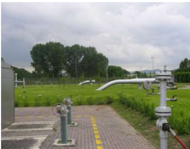
Foto 74 - Area interna a prato. Impianto di compressione di Melizzano (BN) - Foto Snam Rete Gas
