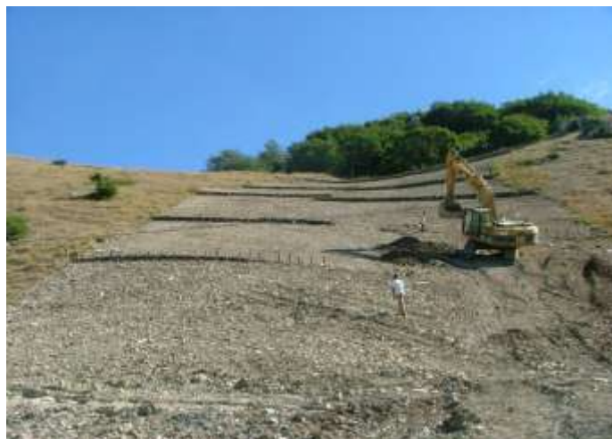
Foto 4 - Riprofilatura del terreno con opere di regimazione superficiali - 5° tronco: versante P. 126/130 Loc. S.P. Montasanagrina, Vastogirardi (CB) - Foto Snam Rete Gas
