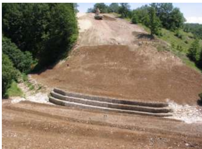
Foto 9 - M. Sei Busi Monfalcone (GO) – Visibile il tracciato dell'oleodotto transalpino soggetto a pulizia periodica (a destra) parallelo al recente metanodotto inguainato (a sinistra) non soggetto a pulizia – Foto G. Sauli, 2010
