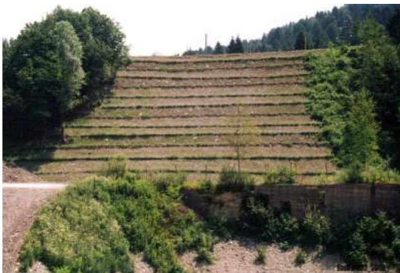
Foto 44 - Metanodotto Malborghetto – Bordano (UD) Loc. Pontebba. Gradonate vive e canaletta con graticciata – Foto G. Sauli, giugno 2003
