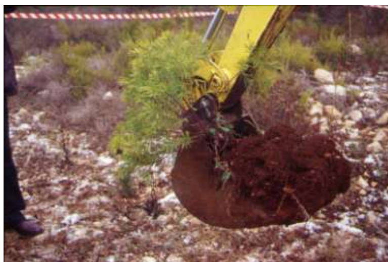
Foto 64 - Metanodotto Bernalda – Brindisi, Loc. Massafra, lavori di trapianto di arbusti di gariga mediterranea – Foto G. Sauli, dicembre 2001
