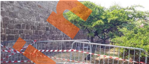
Fig.13 - Voragine presso Via dei Giardini 2018; crollo di una porzione delle Mura Medievali perimetrali di Viterbo. - Sinkhole at "Via dei Giardini", 2018; collapse of a portion of the Medieval Walls perimeter of Viterbo.
