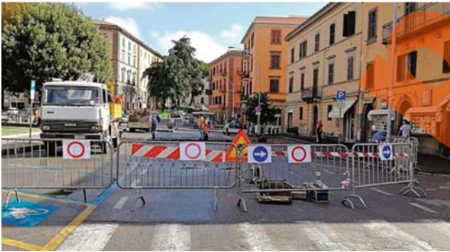
Fig.12 - Voragine a piazza della Rocca 16 settembre 2018. - Sinkhole in Piazza della Rocca, 16 September 2018.
