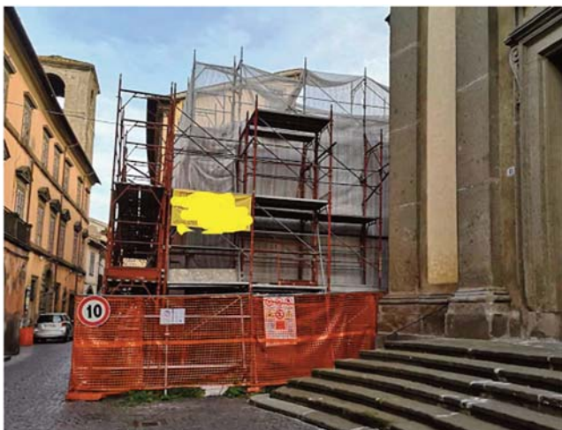
Fig. 15 - 2013, Crollo di un Palazzo presso Via Cardinale La Fontaine. - 2013, Collapse of a building in Via Cardinale La Fontaine.
