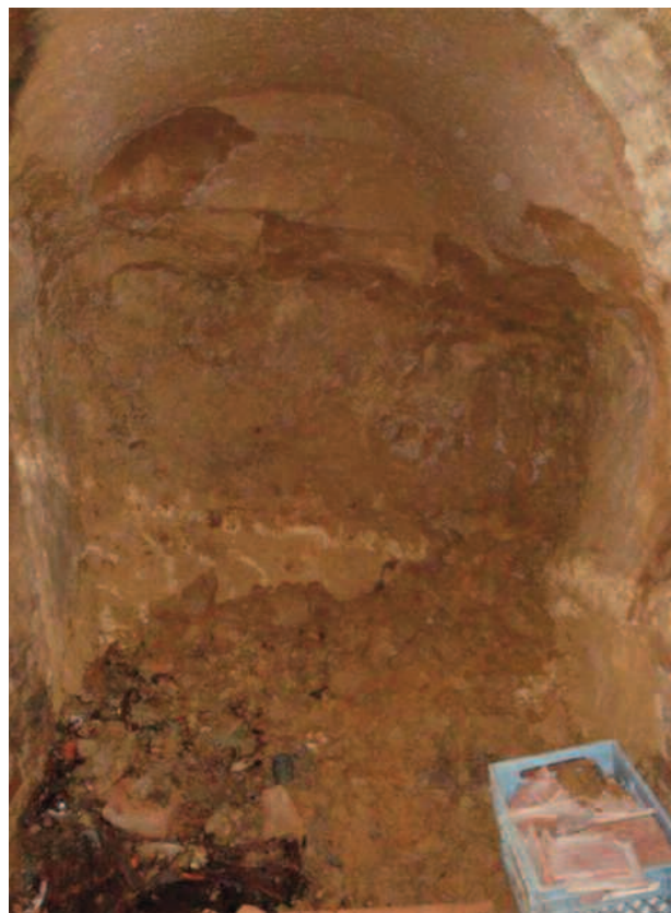
Fig. 17 – Distacchi di detriti dalle pareti della cavità. – Debris detachment from cavity walls.
