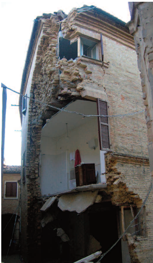
Fig. 4 – Edificio crollato l'8 agosto 2010. – Building collapsed on August 8, 2010.
