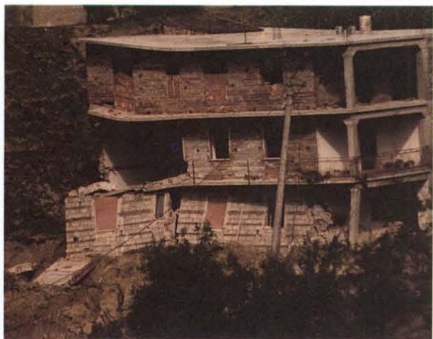
Fig. 103. – Territorio comunale di Aciri in provincia di Cosenza. Effetti di un modesto movimento franoso per scorrimento su un fabbricato in costruzione, gennaio 1981 (fotografia di L. Merenda, CNR-IRPI Cosenza).
