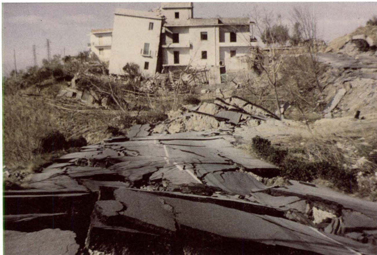
Fig. 102. – Territorio comunale di Paola in provincia di Cosenza. Dissesti a seguito di un movimento franoso, gennaio 1980 (fotografia di L. Merenda, CNR-IRPI Cosenza).
