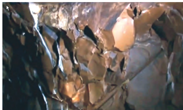
Fig. 5 - Segni dei fori eseguiti per abbattimento della roccia. - Signs of the drilled holes for blasting rock.
