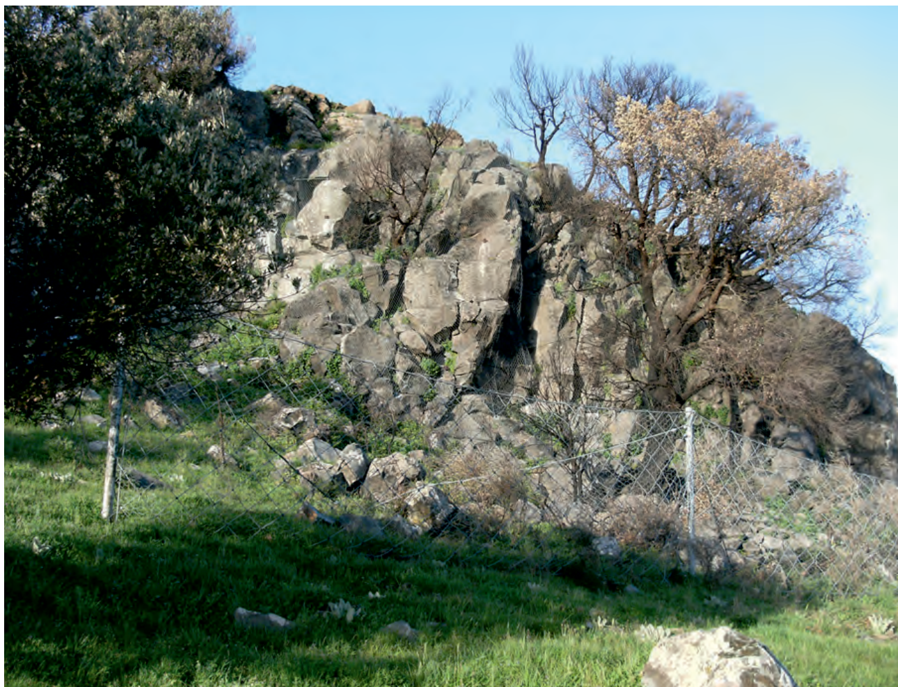
Fig. 12 - Rete metallica di contenimento sulla parete di basalto e quella paramassi alle sue pendici. - Metal mesh containment on the basalt wall and gabions on its slopes.
