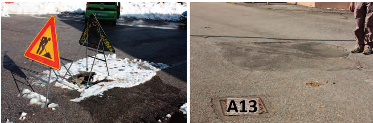
Fig. 4 - Cedimenti nell'abitato di Quinis. Sono evidenti tre diversi riporti di materiale bituminoso. - Subsidence in Quinis Village. Three different asphalt layers were reported within the years.
