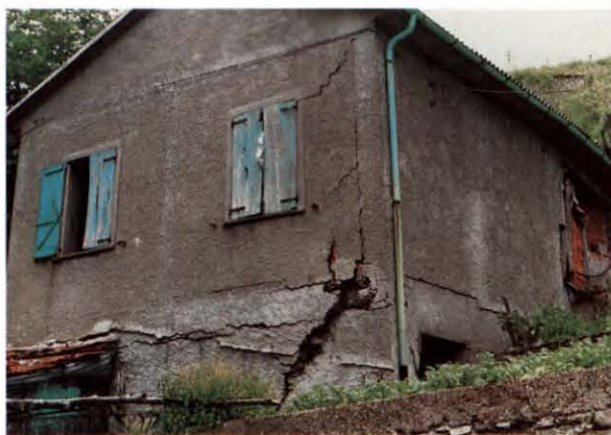
Fig. 53. - Uno dei fabbricati coinvolti dalla frana di Camporaghena, in territorio comunale di Comano (Lunigiana), provincia di Massa Carrara. Movimento franoso attivo nel luglio 1987 (fotografia di Raffaele Nardi, Dipartimento Scienze della Terra, Università di Pisa).
