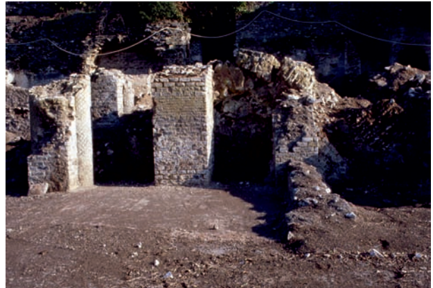
Fig. 9 – Barco Borghese, settore esterno occidentale: dettaglio del crollo a libretto di pareti e volte nel settore più meridionale (foto: M. Valenti). – Barco Borghese, external view of the western area: detail of walls and vaults collapsed in the southernmost sector (photo: M. Valenti).
