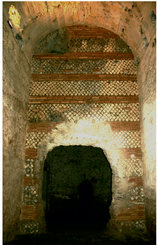
Fig. 15 – Barco Borghese: tramezzo murario eretto nel corridoio n. 140 (foto: M. Valenti). – Barco Borghese: partition-wall built in room no. 140 (photo: M. Valenti).
