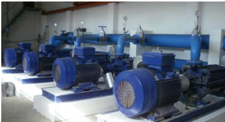
Figura 3 - Stazione di pompaggio di Piscille, Perugia
