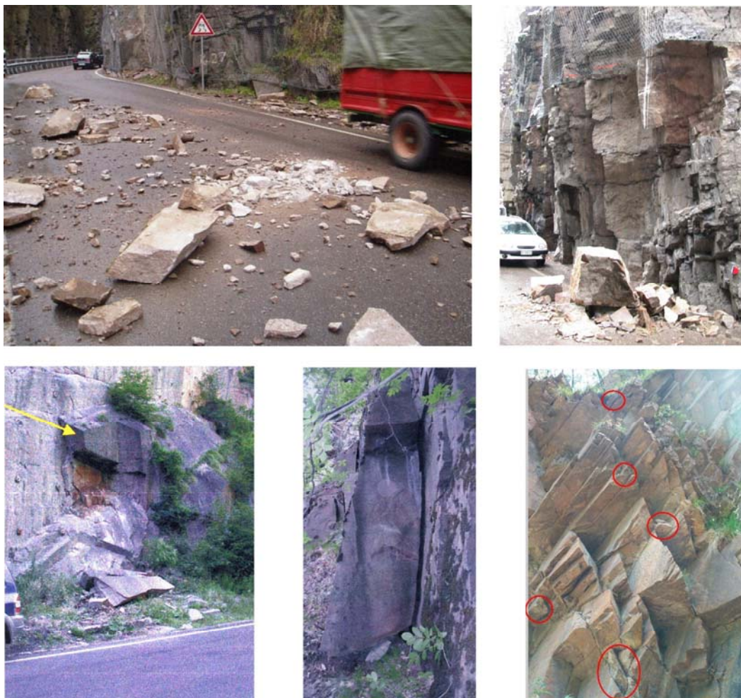
Figura 8.8 Documentazione fotografica relativa a crolli all'interno dell'area 210076000 lungo la SS 241.
