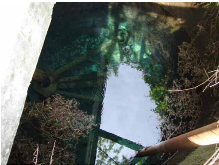
Figura 3.13 - Pozzo ad anelli – Località Viadana Bresciana GW 3005
