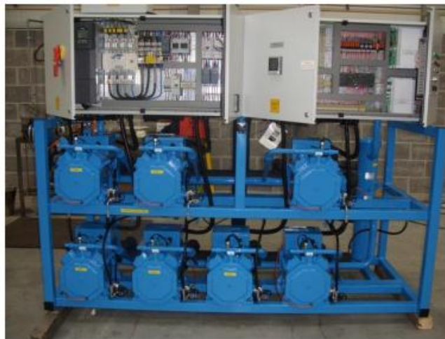
Figura 4.7 - Esempi di sistemi di refrigerazione centralizzati (Fonte: UNEP Ozone Secretariat Fact Sheets 4, 2015)
