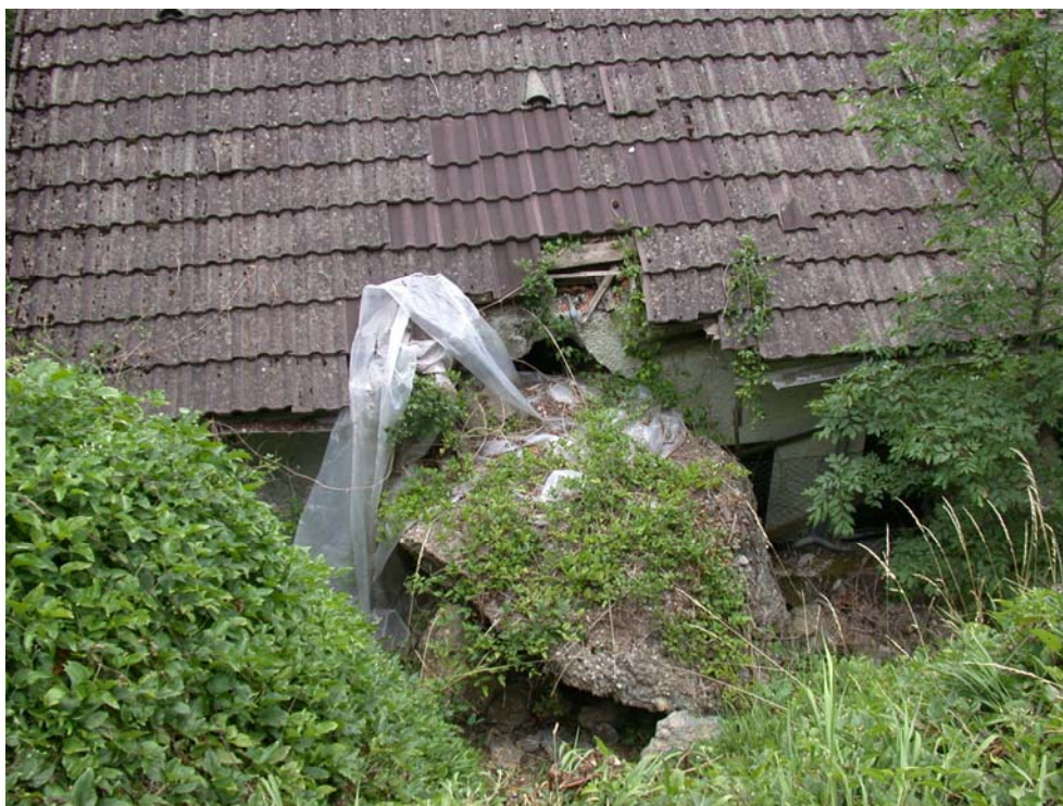
Figura 3.22 Abitazione danneggiata da un fenomeno di crollo, Crocefieschi (GE).
