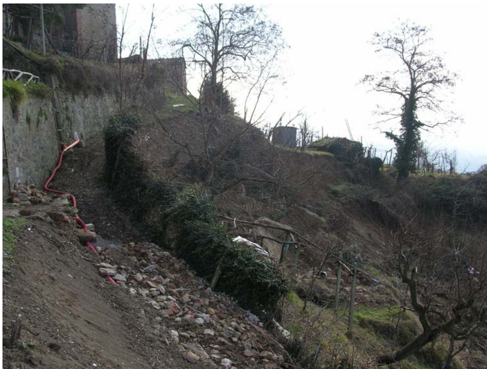
Figura 15.42 Evento meteorologico novembre 2005 - Scivolamento sotto le mura dell'abitato di Monteleone d'Orvieto (TR).
