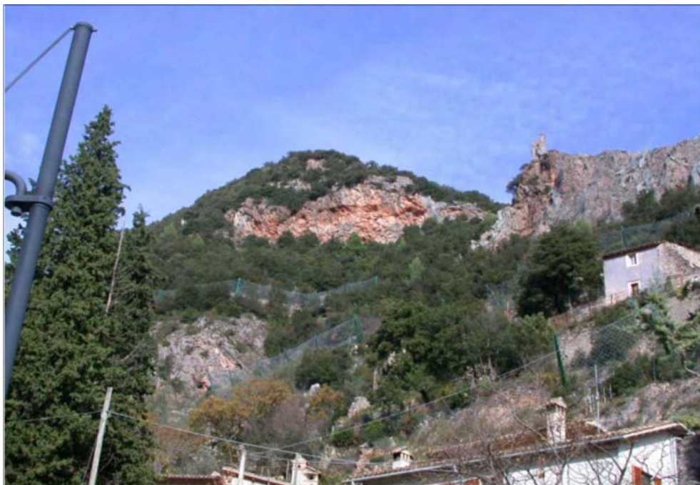
Figura 15.17 Parete rocciosa su Scaglia Rossa soggetta a frane di crollo in località Piedipaterno, Valnerina.
