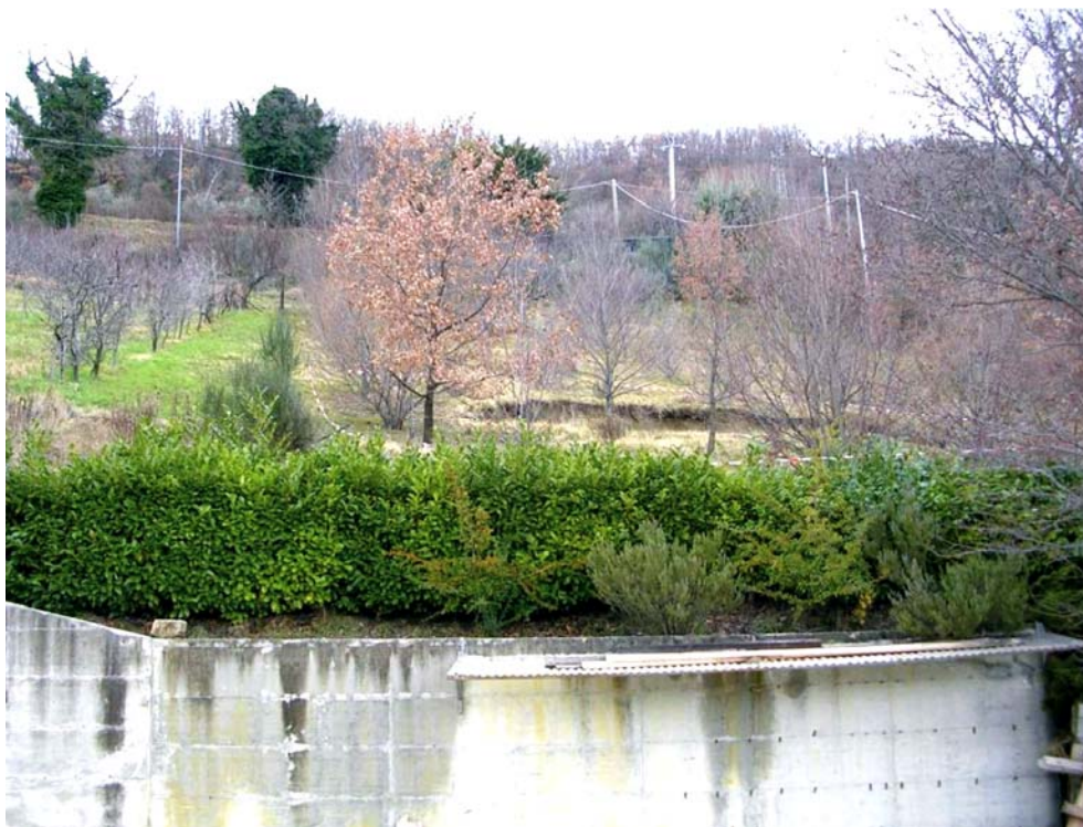
Figura 15.41 Evento meteorologico novembre 2005 - In secondo piano, scarpata di frana di scivolamento su coperture colluviali in località Africa, comune di Nocera Umbra (PG).
