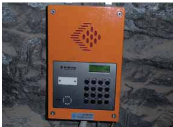
Figura 12. Particolare di citofono in galleria
