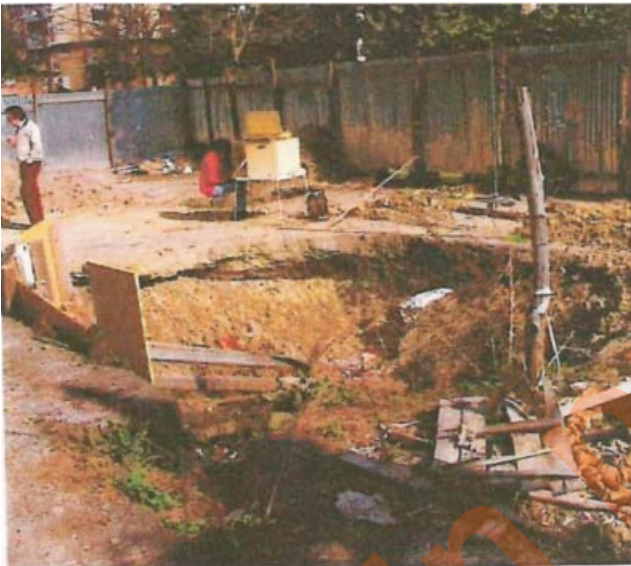
Fig. 24 - Indagini con ispezioni video in foro a seguito di una voragine in Via Giannetto Valli. - Investigations with video inspections in the geognostic borehole following a sink-hole in Via Giannetto Valli.
