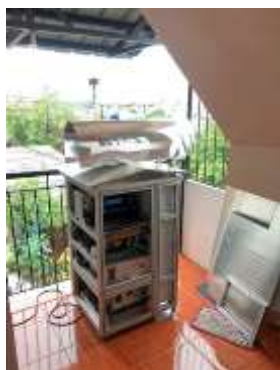
Fig. 39 – Strumentazione per il monitoraggio.
