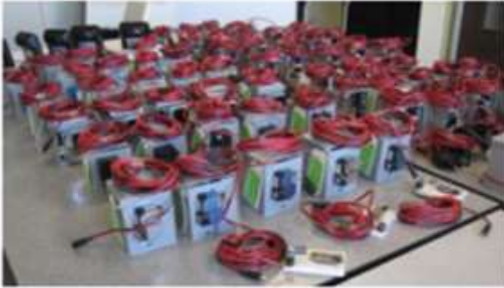
Fig. 33 – Strumentazione per il monitoraggio.
