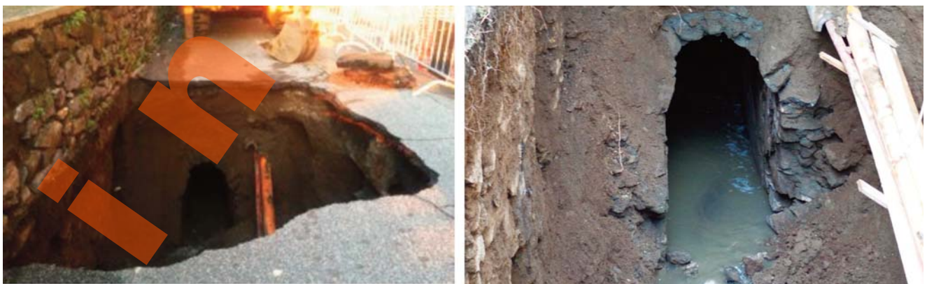
Fig. 13 - Voragine in Via del Fossato Novembre 2014 e galleria individuata. - Sinkhole in Via del Fossato November street 2014, and tunnel identified.
