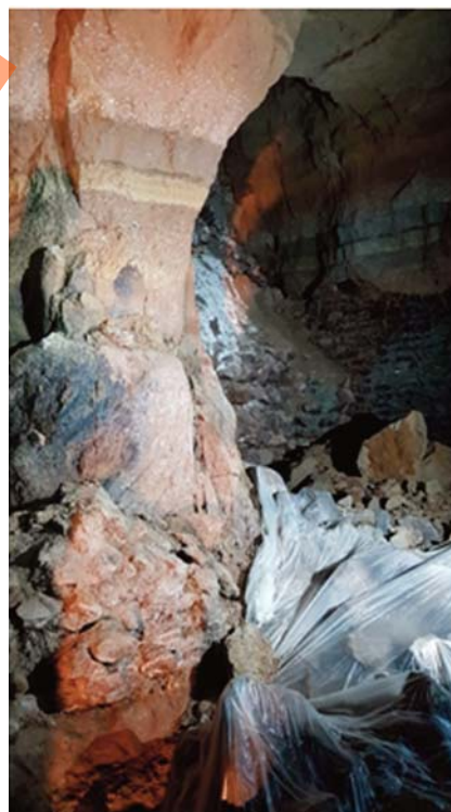
Fig. 11 - Crolli presso l'ipogeo di Via Fioravanti. - Collapses near the hypogeum of Via Fioravanti.
